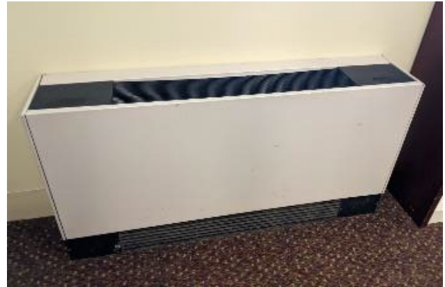
Fan Coil Unit
